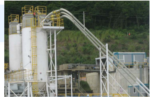
Tuberías de transporte acopladas a cada instalación
