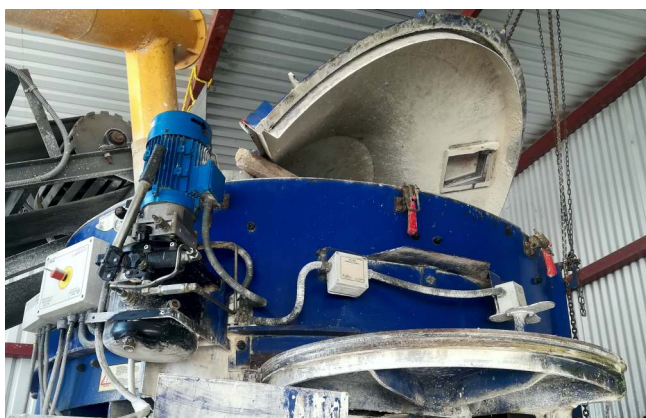
Misturadora instalada para a produção de pré-moldados.
