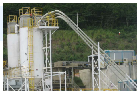
Tuberías de transporte acopladas a cada instalación
